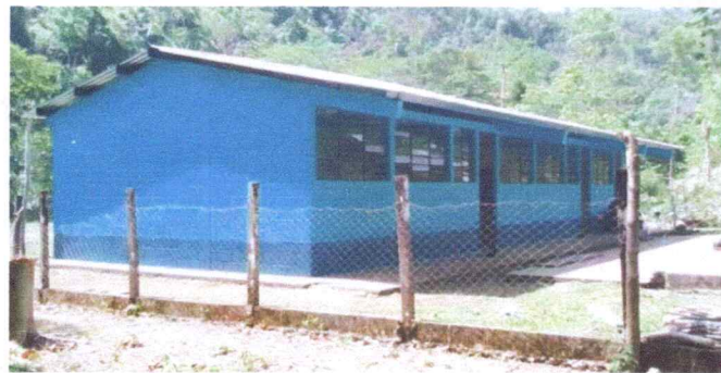
Foto 3: se observa en la fotografía la pintada de las costaneras de metal del edificio.
